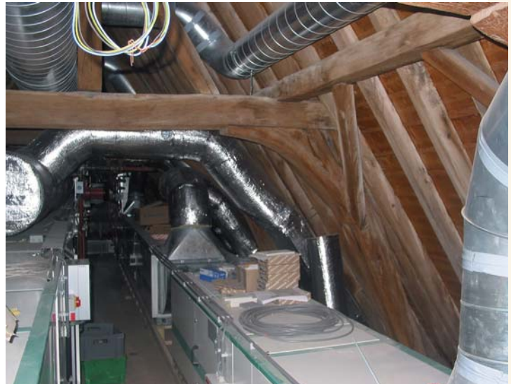
2 ZOLDER NA RESTAURATIE, DE KAPCONSTRUCTIE WORDT NIET MEER VOLLEDIG ERVAREN EN DAGLICHT KAN NIET MEER TOETREDEN
