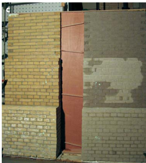
6C NA 5.7-UUR BEREGENING (MET 50 PA OVERDRUK) NA 5.7 UUR IS DE 1-STEENS GELE MUURVOLLEDIG DOORGESLAGEN. DE GRIJZE 1-STEENS MUUR, NU NOG GEDEELTELIJK DROOG, SLAAT NA 22 UUR DOOR.
